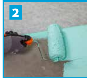
550 Waterproofing Mat 1 monteras med överlapp förlöpande i den våta 553 Multiseal Membrane/560 Vapour Component Glue /580 2K Membrane. Håll överlappet i golv-vägg-vinkel fritt från membran eller lim.
